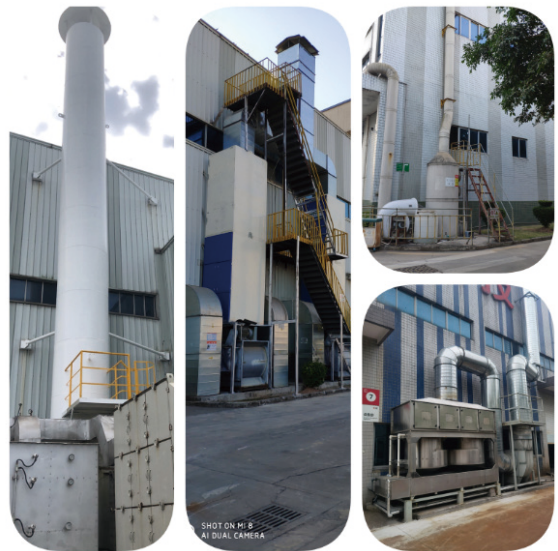
➤ 廢氣處理設備
